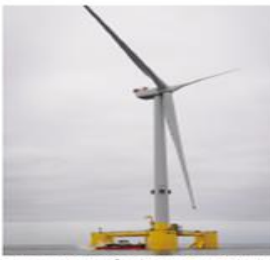
プロデューシングエナジーがスコットランド沖で開発し、運転開始した浮体式洋上風力発電所
