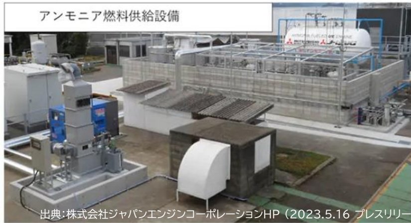
アンモニア燃料供給設備
