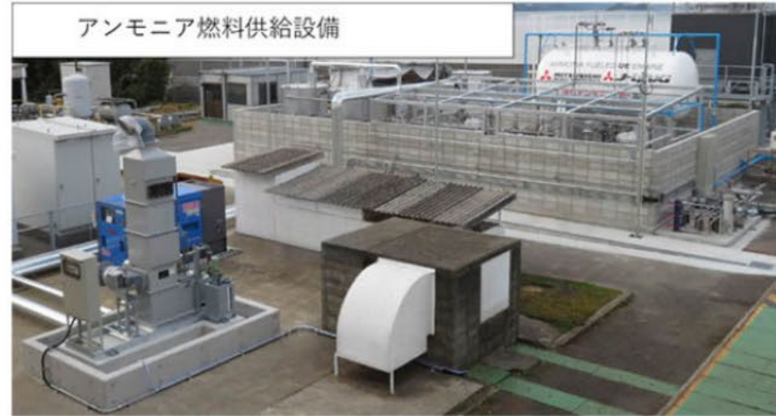
アンモニア供給設備
