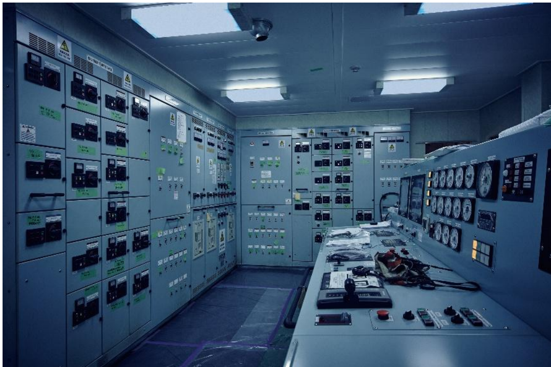
船内の配電盤等の電気設備 BEMAC(株)提供
