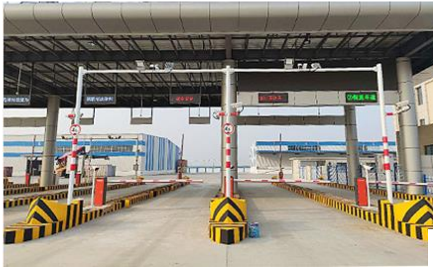
メインコントロール ロール パネル
